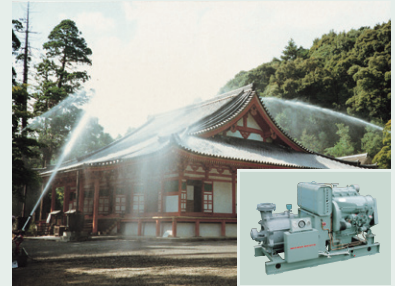
文化財寺院用 (岡山県) For historic temple (Okayama) 出力 40kW
