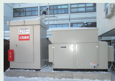
消防デジタル予備用 (北海道) EG at radio relay station of fire department (Hokkaido) MAS-50SS (50kVA) 空冷式 寒冷地仕様 (-20℃)、長時間運転型 (油庫式)
