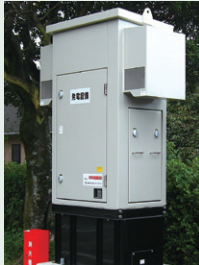
コミュニティーFM予備用(山口県) EG at broadcasting relay station (Yamaguchi) MAS-5S(5kVA) 空冷式
