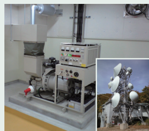
民放・デジタル放送中継送信所予備用(岐阜県) EG at broadcasting relay station (Gifu) MAB-10(10kVA) 空冷式
