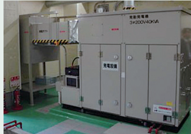
気象レーダーシステム予備用(鹿児島県) EG for weather radar system (Kagoshima) MAS-40(40kVA) 空冷式/屋内設置
