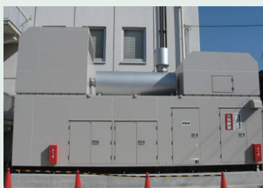
電力会社オフィスビル予備用 (群馬県) EG at office bldg. of electric power company (Gunma) MAS-W-100SSS (100kVA) 水冷式 極超低騒音型、黒煙低減装置搭載
