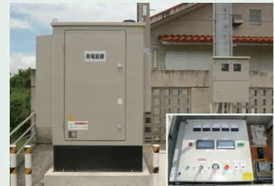
マンホールポンプ予備用(沖縄県) EG for manhole pumping station (Okinawa) MAS-20S(20kVA) 空冷式 塩害対策型、設置面積対策型
