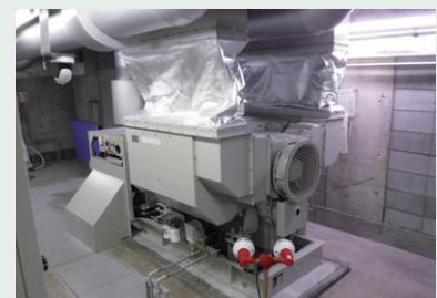
電力会社オフィスビル予備用(千葉県) EG at office bldg. of electric power company (Chiba) MAB-250(250kVA) 空冷式
