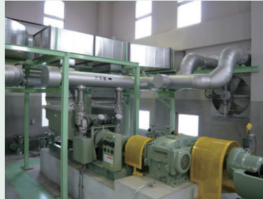
排水機場 (山梨県) For drainage pumping station (Yamanashi) 出力 199kW
