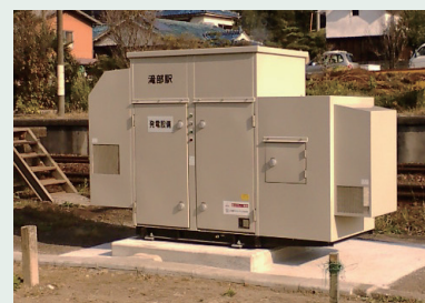
鉄道信号機予備用 (山口県) EG for railway signals (Yamaguchi) MAS-5SS (5kVA) 空冷式 塩害対策型、防風雨対策型
