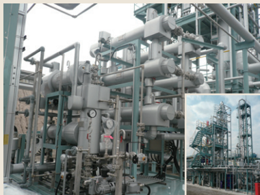
バイオエタノール製造プラント(新潟県) Bio-ethanol production plant (Niigata)
