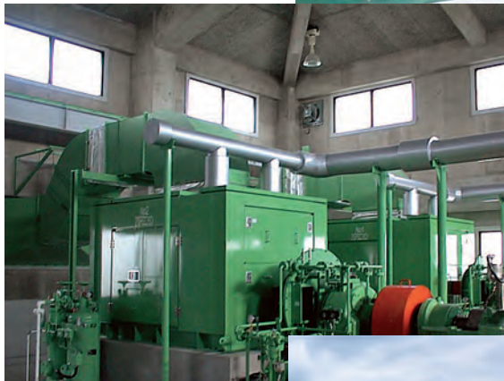
農林事務所所轄排水機場
